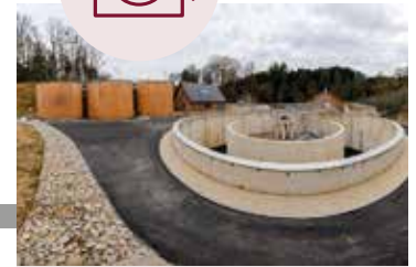
Kläranlage Beaufort (Sidest)
